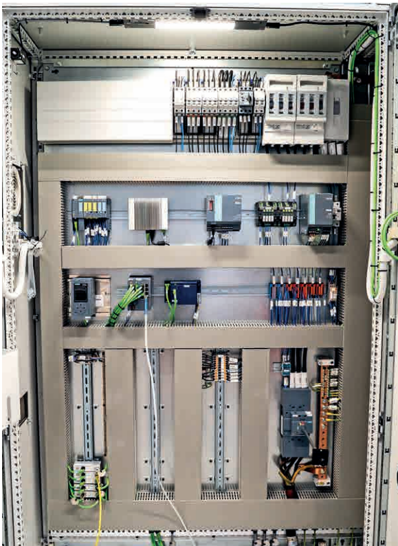
清空控制柜：借助分布式I/O理念，模块化机器的控制柜腾出了大量空间
