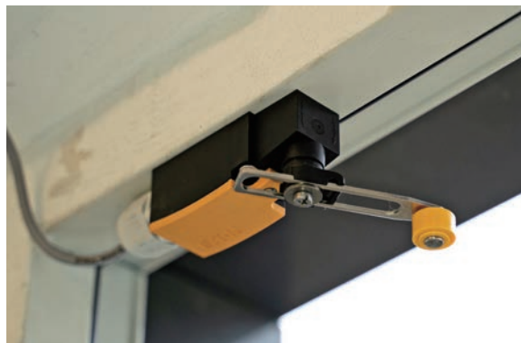
在进行控制柜保护系统改造期间，并未考虑安装成本较高且不安全的柜门触点或滚轮开关
