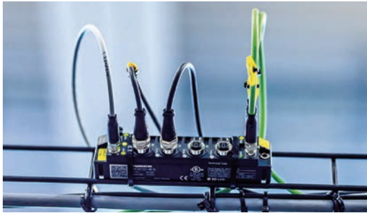
LED信号灯通过图尔克紧凑型TBEN-S2 I/O模块连接
