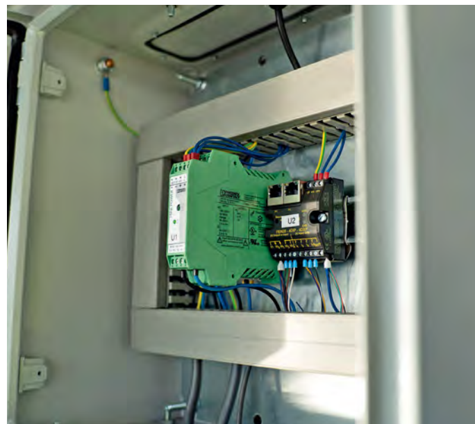
现场中的迷你控制器：紧凑型FEN20 I/O模块（右）使用其集成的AGREE逻辑，将激光扫描仪的开关信号转换为信号指示器的4种状态
