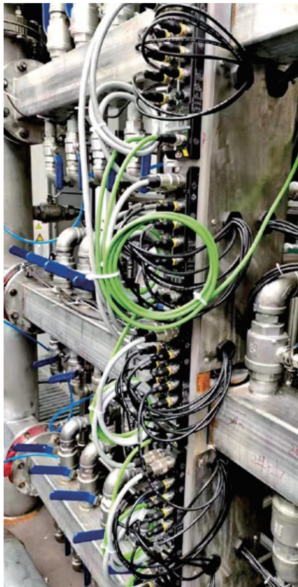
相关过程数据和测量值通过图尔克的 IO-Link主站传输到控制器
