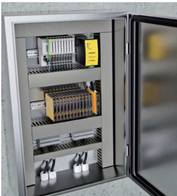
状态监测：CCM控制柜监视器记录的状态数据允许进行预见性维护从而提高系统可用性
