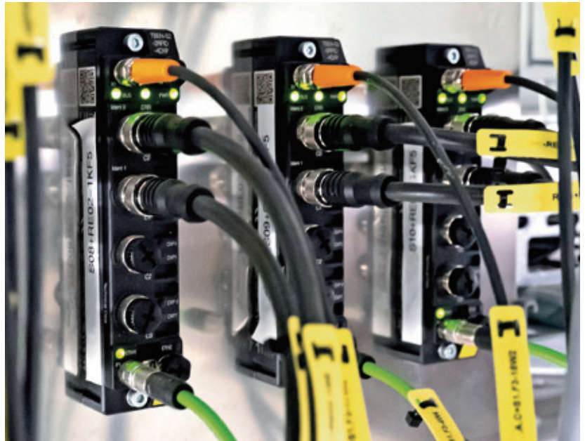
具有IP67防护等级的图尔克TBEN RFID接口，在仓库的无机柜式安装中通过螺钉固定在金属面板上
