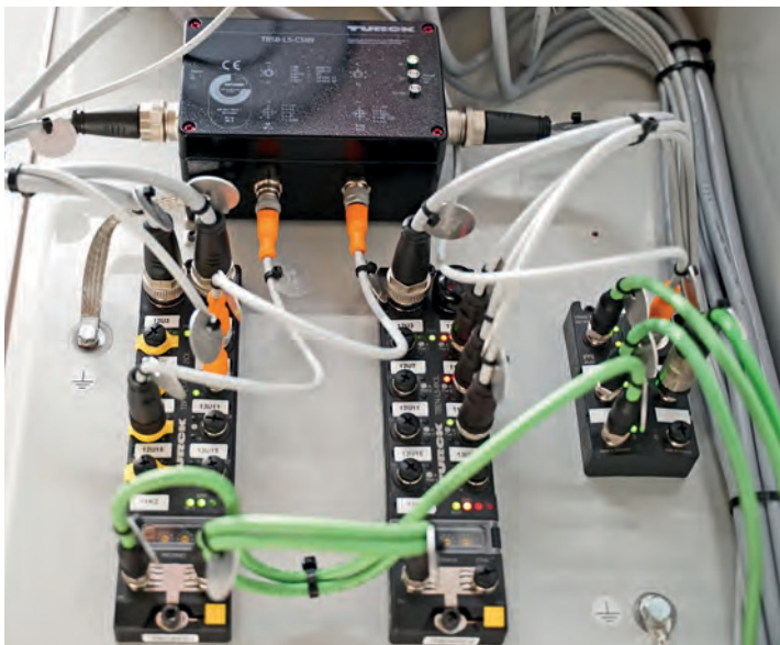
该安全应用由TBPN（左）控制，用于工厂中的测试。Profisafe控制器则在最终客户侧接管应用的实际运行。所有连接至IO-Link master（中）的执行器都通过TBSB Box进行安全关断
