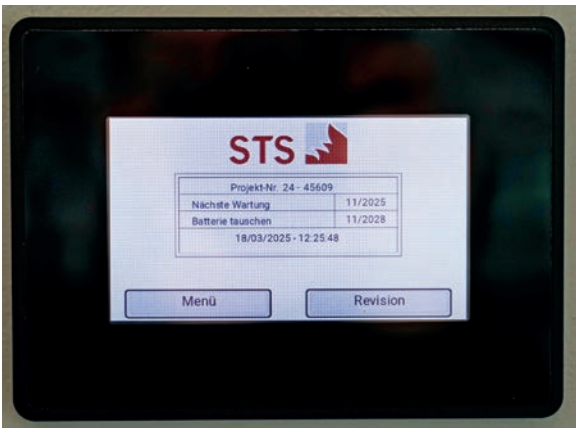
控制程序的可视化层由Turck Mechatec移植至TX107
